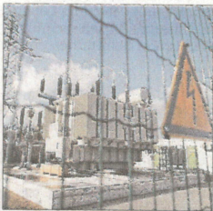
Die Windpark Ostermoor GmbH betreibt in Ramsloh auch ein eigenes Umspannwerk.
